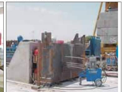
Unidad de bombeo a motor
