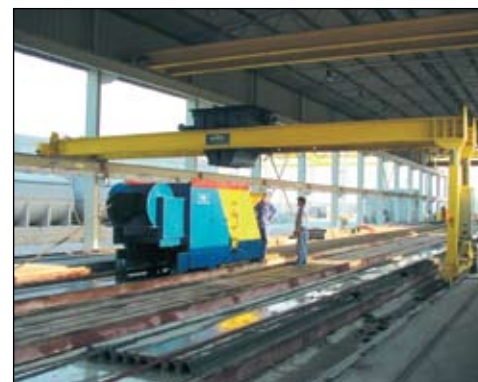
Distribuidor automático de hormigón
